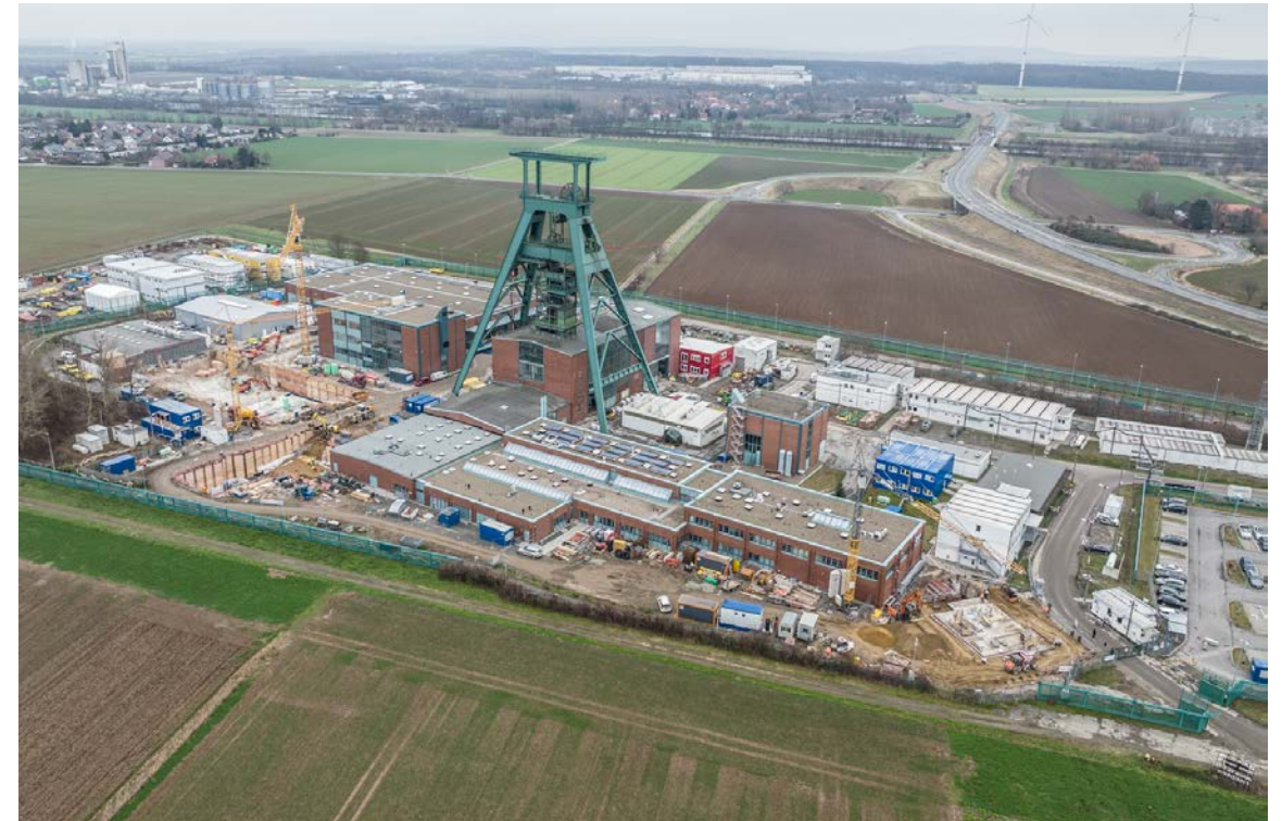
Dezember 2021: Großteil der Gebäude ist bereits fertiggestellt. Aktuell wird das neue Wachgebäude errichtet (vorne im Bild).
