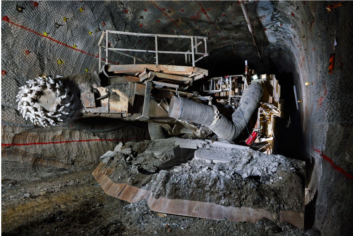
Blick in eine Einlagerungskammer (Streckenbau) – hier werden später die Behälter mit den radioaktiven Abfällen eingelagert.
